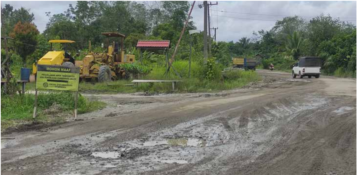
Terlihat jalan hanya ditimbun, genangan air habis hujan memperparah kondisi jalan/12 Maret 2022/foto BIT
